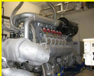
Wärmeerkopplungsanlage: Aus Erdöl, Erdgas wird Strom und Wärme erzeugt.
